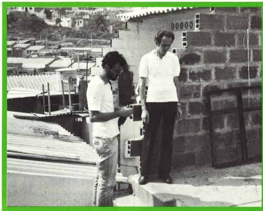
Maurizio e P. Mario controllano i lavori della costruzione del Centro Primavera
