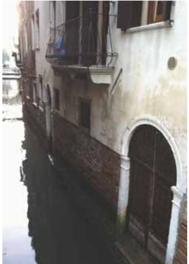
Il piano a livello acqua della casa Miani, con i due portali di accesso per ingresso e scarico merci
