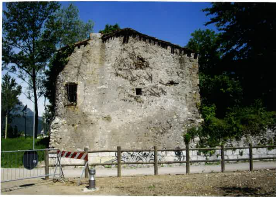
Recente ripresa della garitta costruita sulle mura più antiche ormai quasi invisibili
