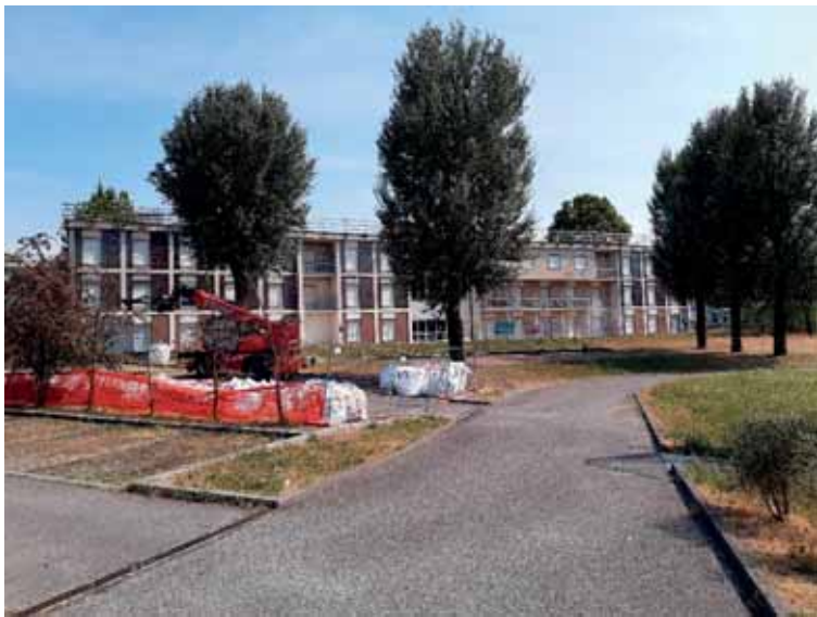
Il complesso del Polaresco che avrebbe dovuto ospitare l'istituto, e che invece nel 1971 fu venduto al Comune di Bergamo per uso scolastico. Oggi in ristrutturazione
