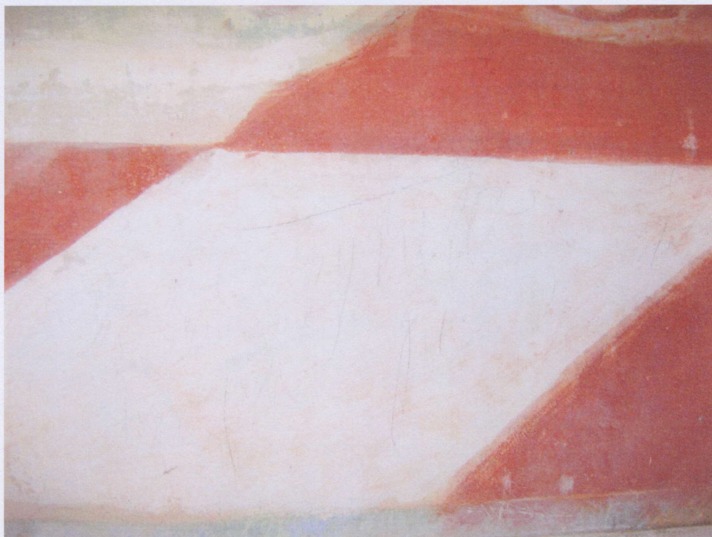
Foto 20. Particolare degli atti vandalici.
