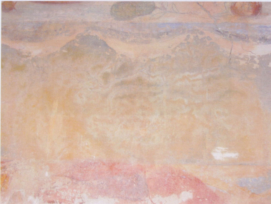
Foto 17. Macchie di umidità presenti sulla superficie.
