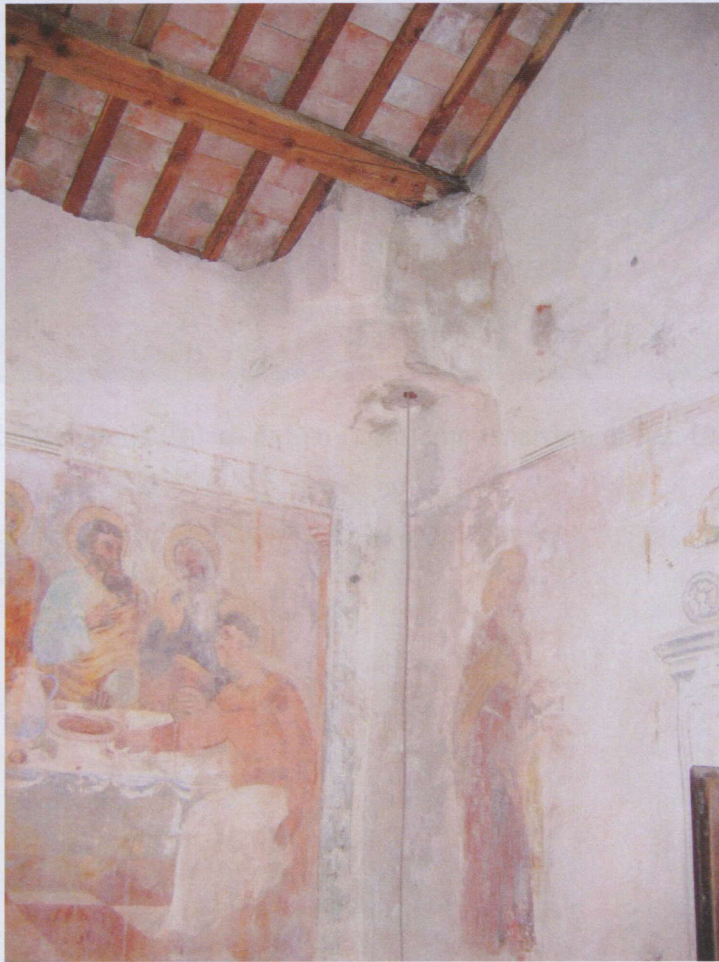
Foto 7. Interno della Chiesa di San Bartolomeo, particolare della zona del campanile in cui è visibile l'acqua di percolazione.
