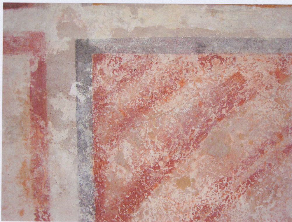
Foto 22. Foto 20. Particolare degrado tipo "alveolizzazione".
