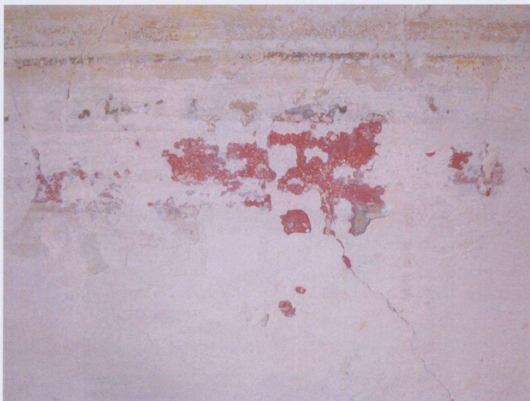
Foto 23. Particolare della tinteggiatura a calce.
