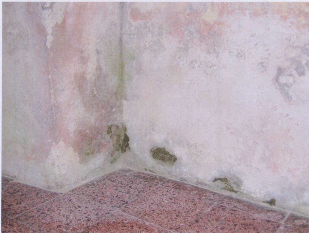
Foto 32. Particolare del muro sottostante con attacco biologico.
