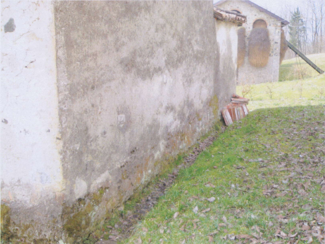
Foto 3. Esterno della Chiesa di San Bartolomeo, parete est, attacco biologico.
