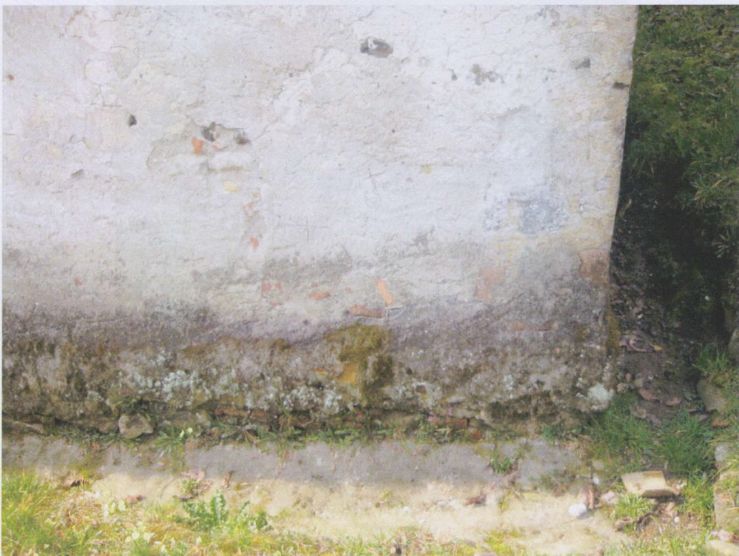
Foto 4. Esterno della Chiesa di San Bartolomeo, parete nord, attacco biologico.
