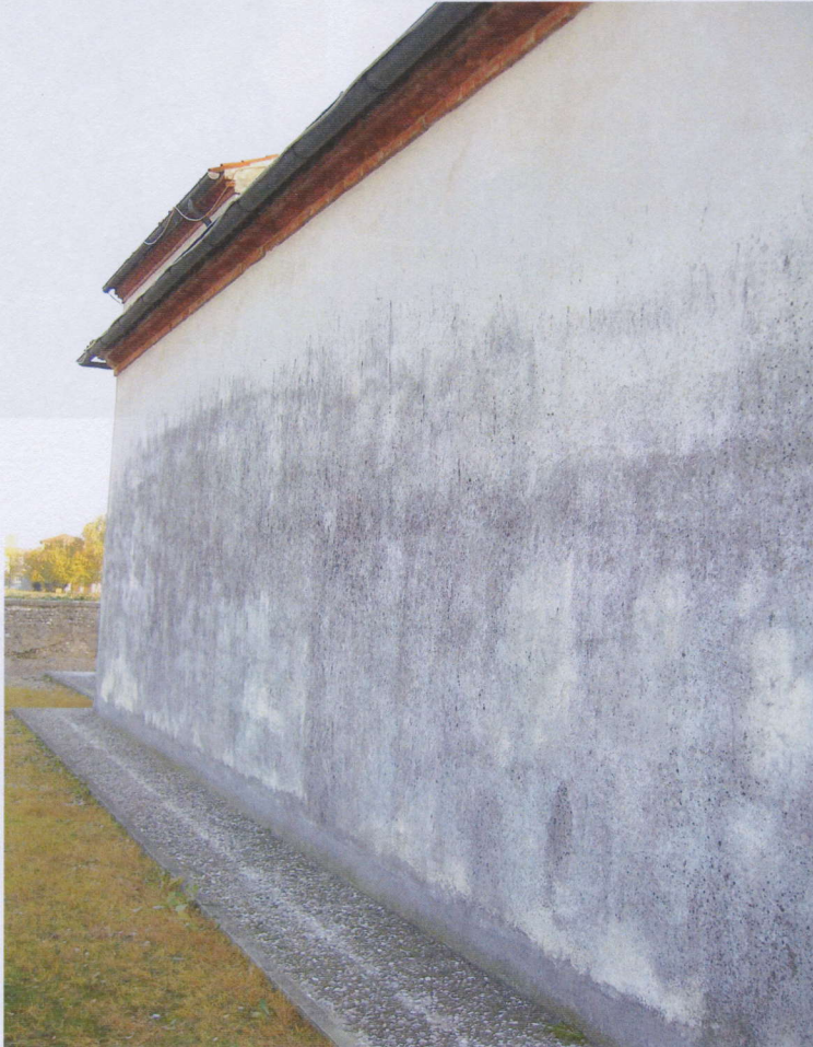
Foto 3. Esterno, parete nord. Particolare del degrado dei causato dai biodeteriogeni.
