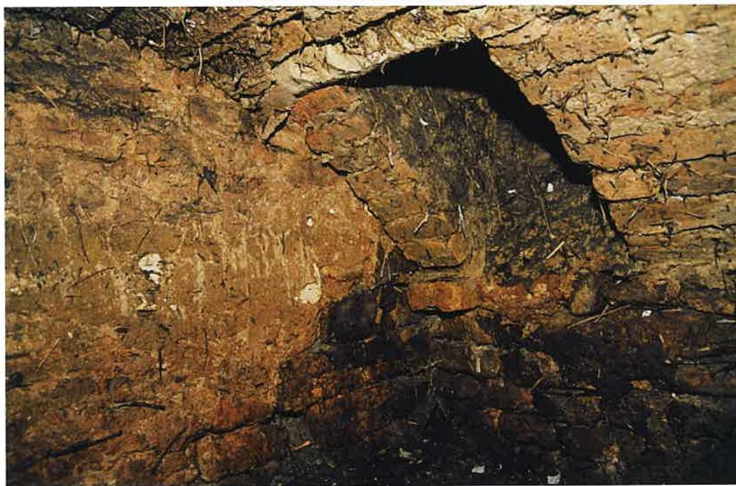
A FIANCO: particolare del foro inglobato nell'imposta della volta di copertura, tipico dei cosiddetti butti; in questi piccoli ambienti, realizzati tra le fondazioni, venivano gettati abitualmente rifiuti inorganici come, per esempio, mattoni, cocci e stoviglie.
