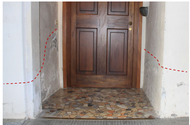
Fig. 19. Fenomeno di risalita capillare riscontrato nella parte inferiore delle pareti. Con la linea tratteggiata viene identificato il fronte di risalita. Somasca, Marzo 2015
