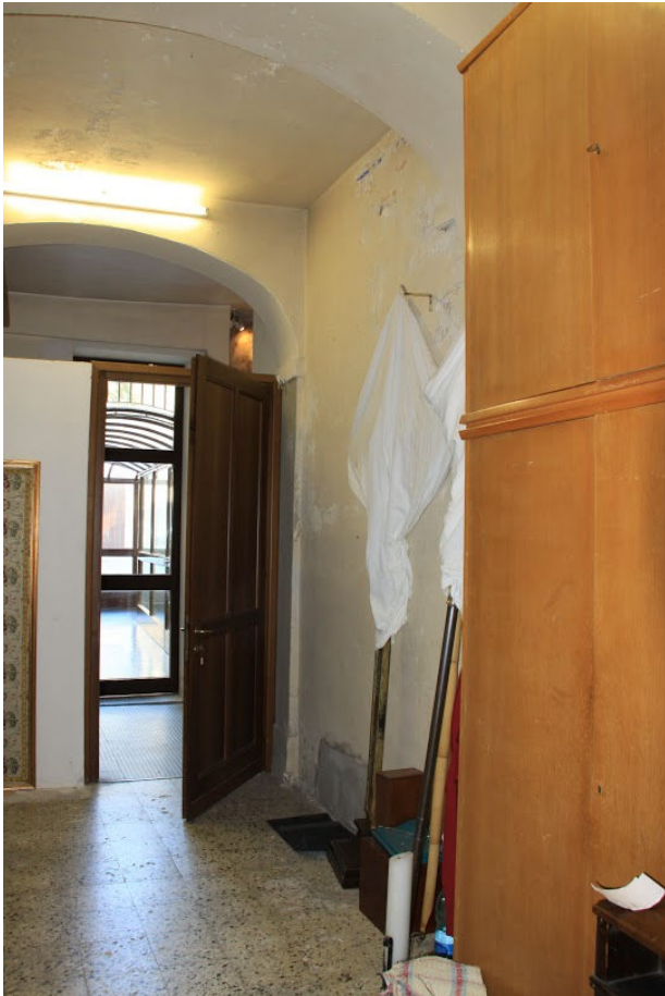
Fig. 20. Stanza predisposta a magazzino confinante con il ciclo pittorico sul lato destro. Si mettono in evidenza i fenomeni di presunta infiltrazione nella parte superiori delle pareti e del soffitto, Somasca, Marzo 2015
