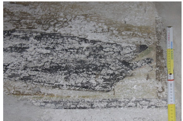
Fig. 16. Fenomeno di alveolizzazione dell'intonaco in corrispondenza del riquadro di "San Girolamo che riposa meditando il Crocifisso", Somasca, Marzo 2015
