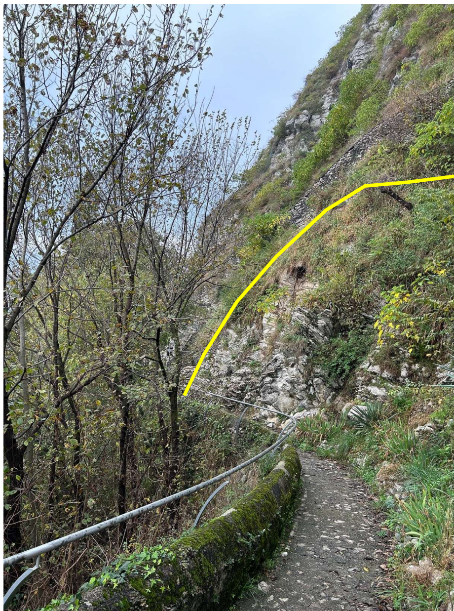
Figura 2.3: Settore in dissesto che richiede il consolidamento – limite ovest
