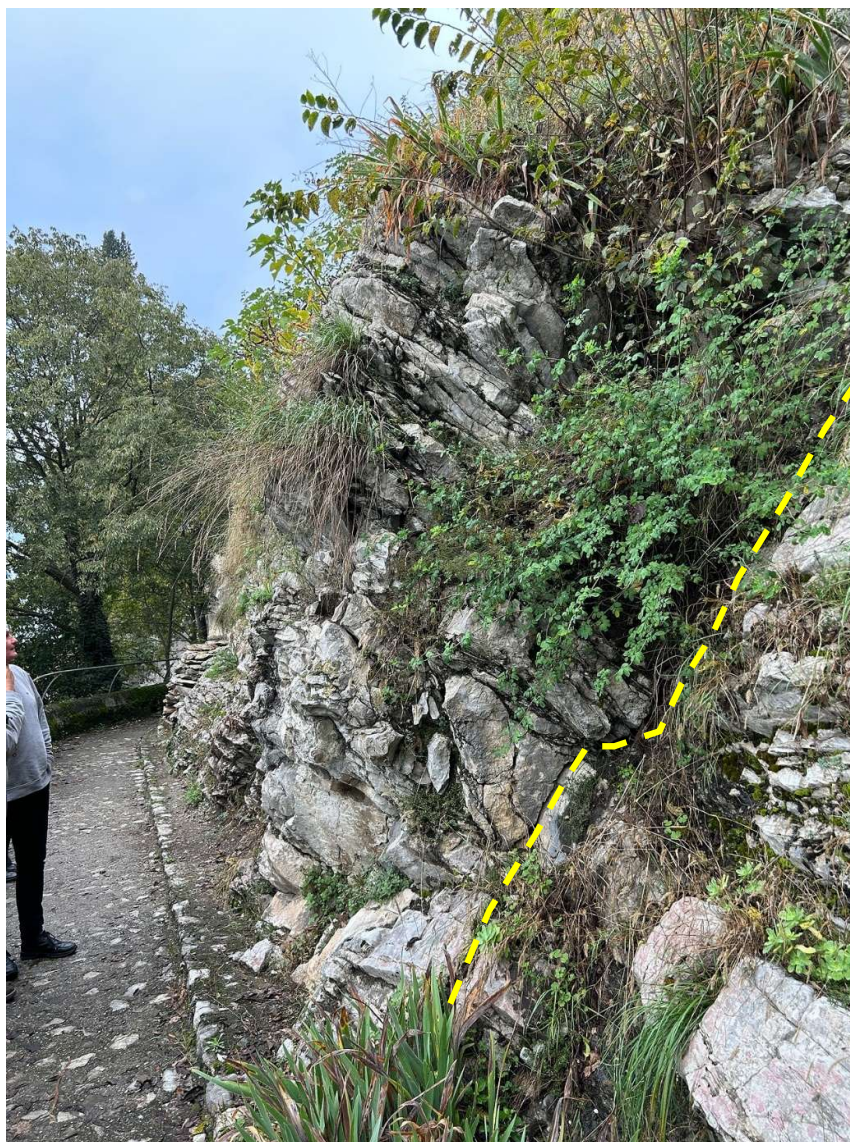
Figura 2.2: Settore a valle della nicchia di crollo – evidenziata la linea di frattura esistente
