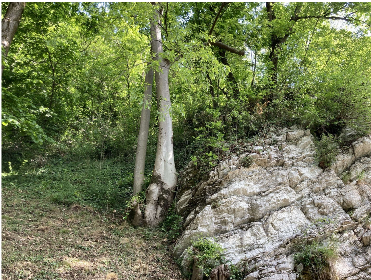
Figura 3.6: Parete rocciosa da consolidare immediatamente a est del Santuario, insistente sul Viale delle Cappelle – primo piano di esemplare di bagolaro da tagliare ed eliminare
