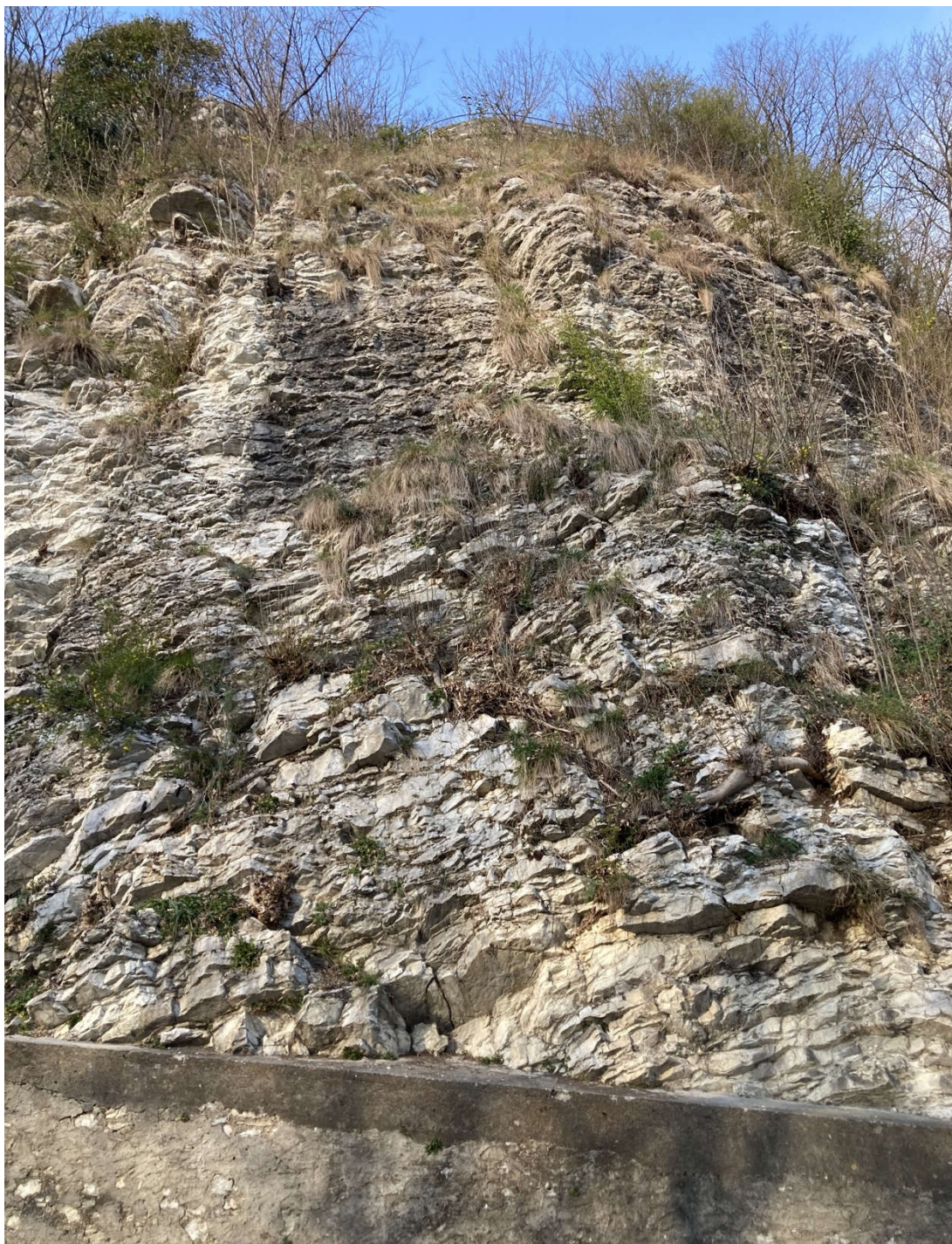
Figura 3.5: Parete rocciosa da consolidare immediatamente a est del Santuario, insistente sul Viale delle Cappelle
