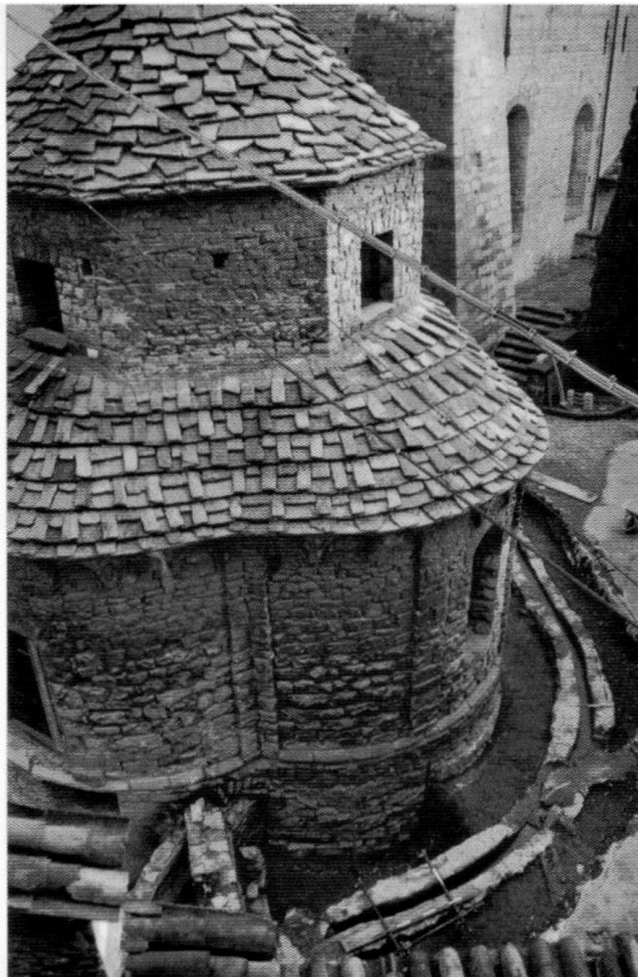
La canalizzazione di età rinascimentale che aggirava la Cappella di Santa Croce
